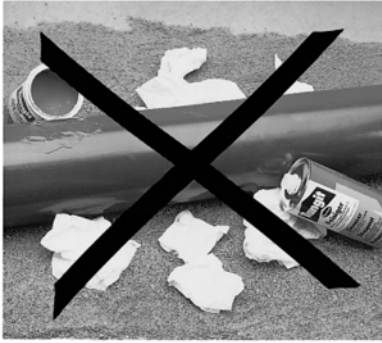
Der Rohrgraben ist keine Abfallgrube
